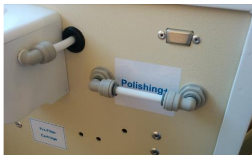
Рисунок 34. Установленная перепускная трубка.
